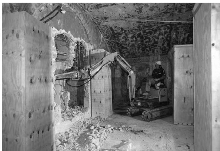
Travaux d'élargissement des passages dans les renforts en béton entre la salle romane et le dôme en septembre 2013.
